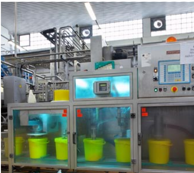
UV-C-Entkeimung im Bereich Joghurt-Abfüllung
