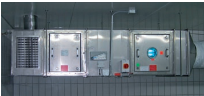
Ausgehend vom deckenmontierten UV-C-Entkeimungssystem gelangt die entkeimte Luft über einen Luftverteilschlauch in den Sliceraum.
